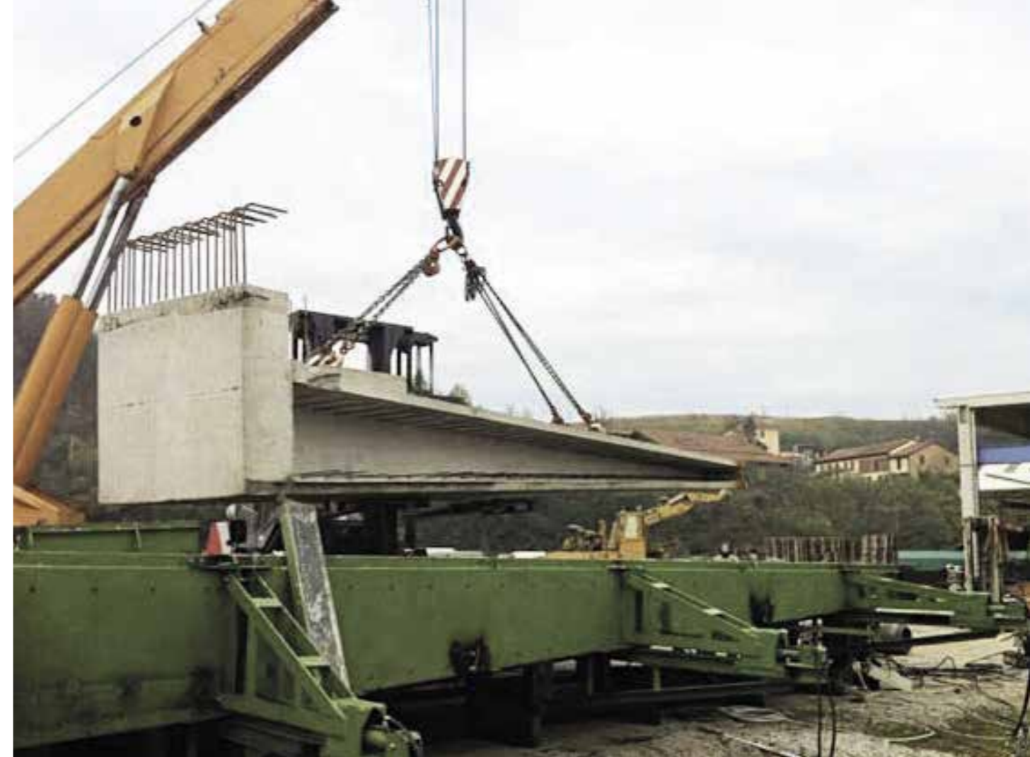
BASSIN DE CARNAGE Production de murs préfabriqués pour la construction du quai. Les artefacts ont été fabriqués à l'aide de coffrages spécialement construit et livré prêt à être monté.
